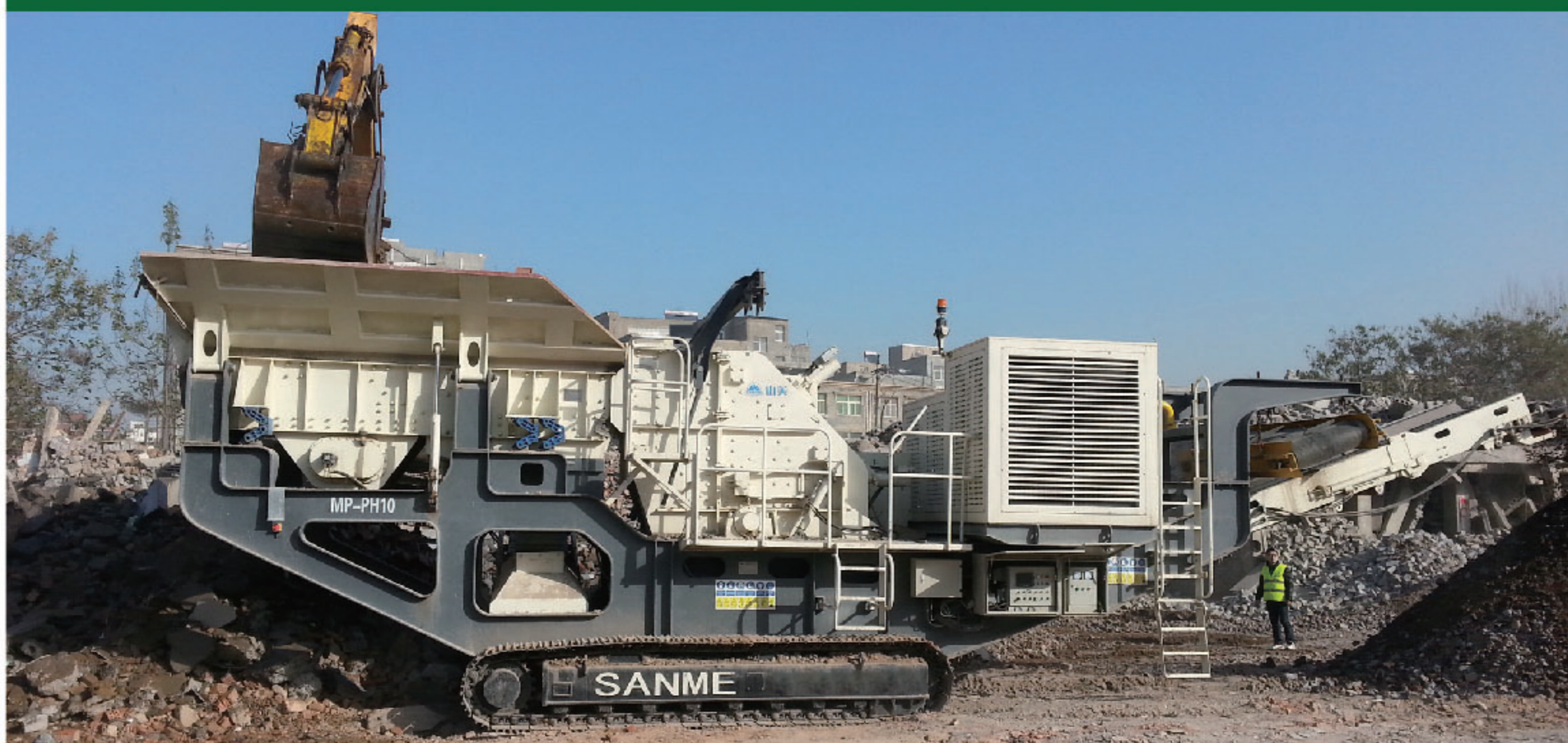
河南 100 吨 / 小时 履带移动式建筑固废资源化利用生产线
