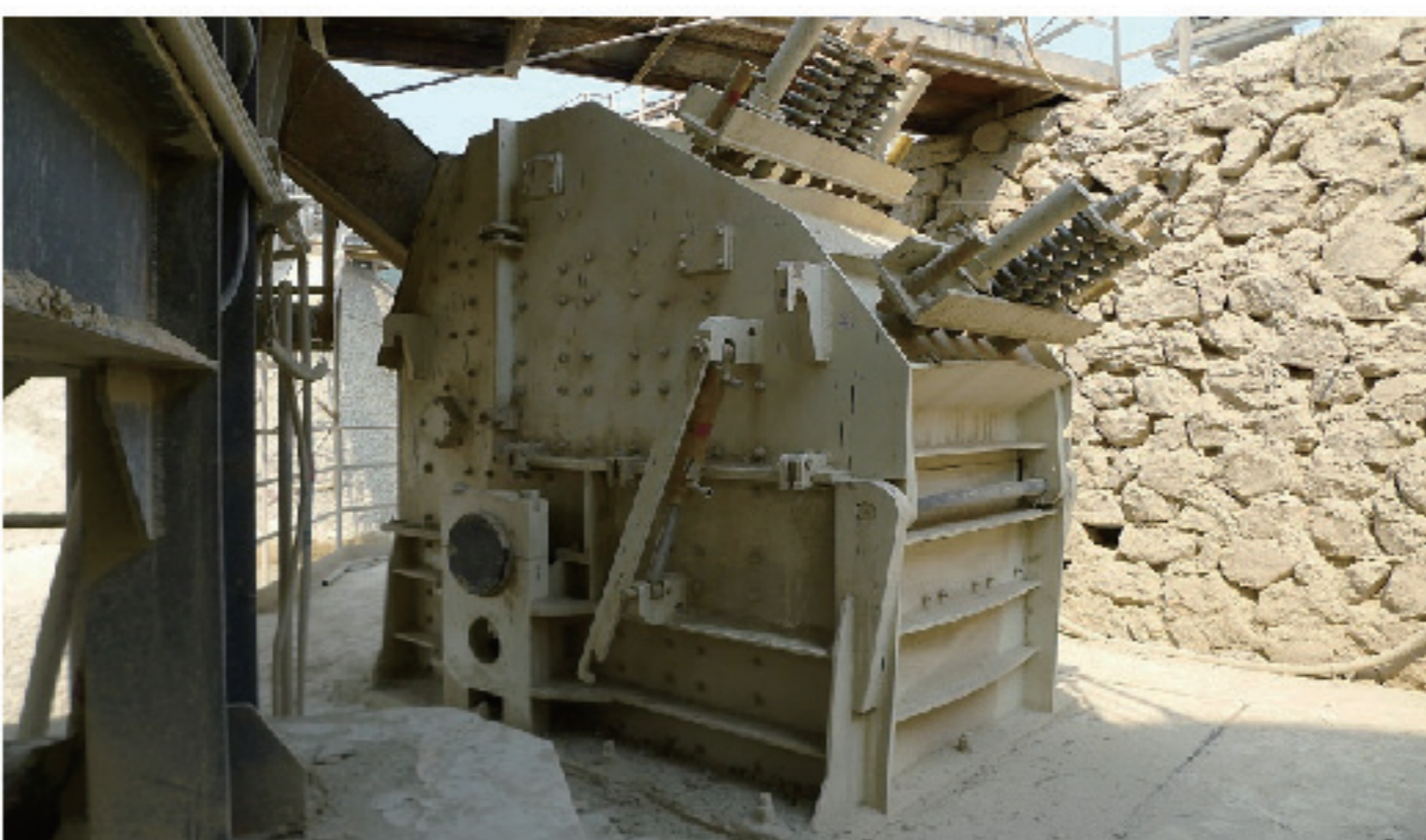
北京金隅水泥厂 Beijing Jinyu Cement Plant 反击式破碎机 Impact Crusher
